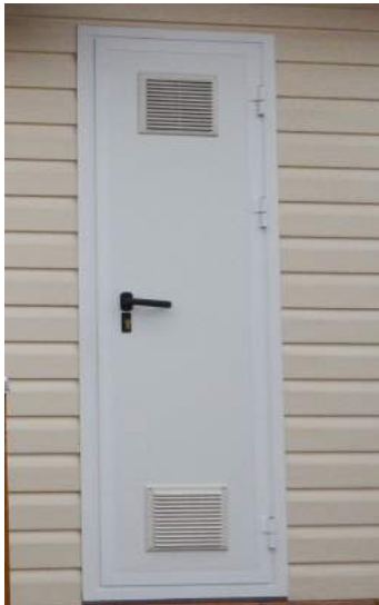
92 particolare porta locale caldaia
